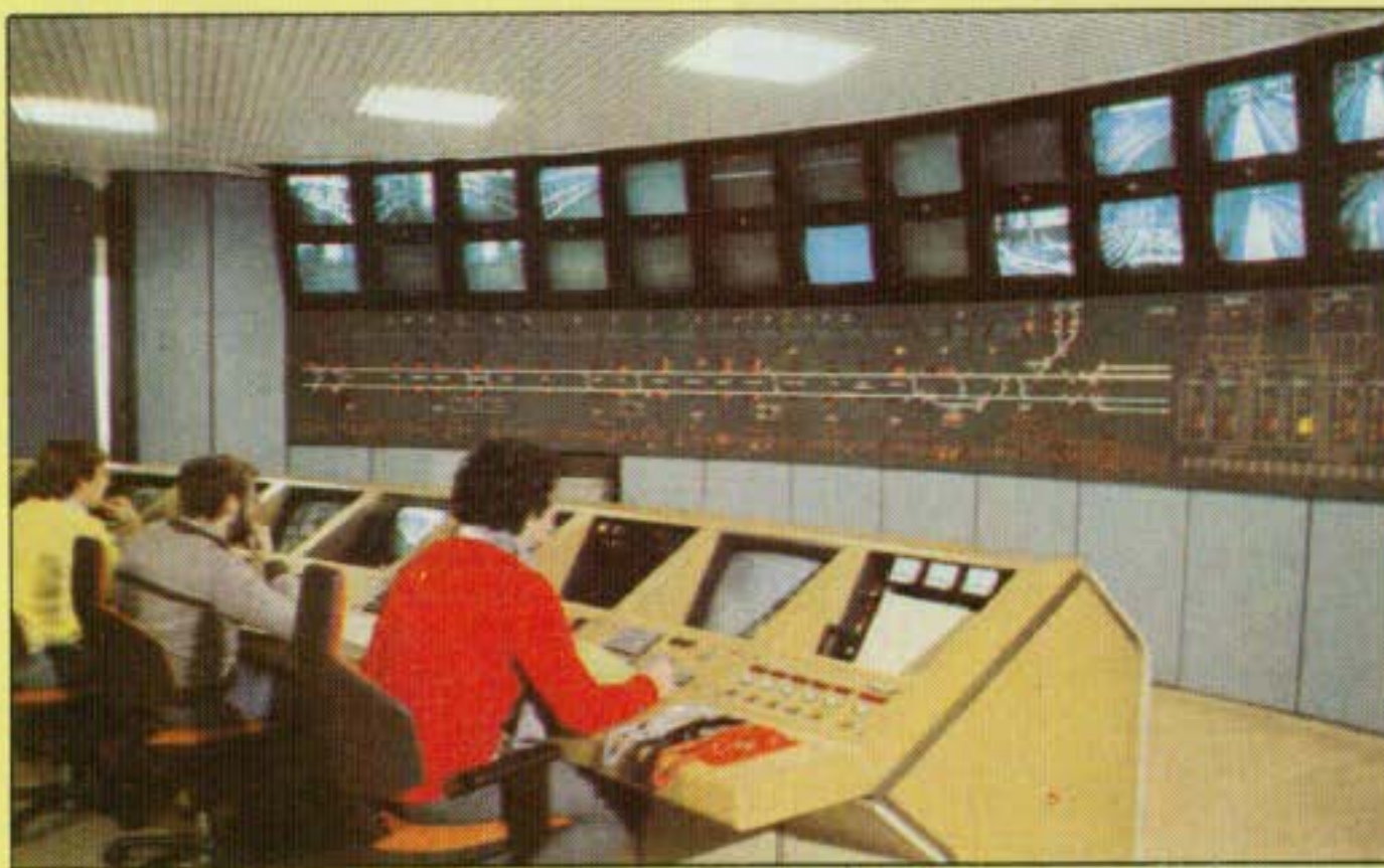
Fig. 1. Centre de contrôle et surveillance. Les opérateurs peuvent, le cas échéant, intervenir sur le système.
