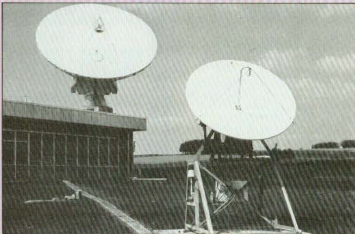
Station de contrôle d'ECS. Redu, Belgique.
