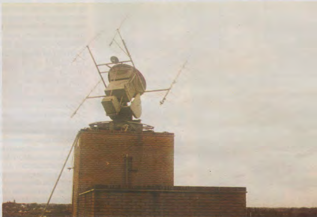
Le bloc des antennes de contrôle et de réception. Le suivi est soit automatique, soit manuel.
