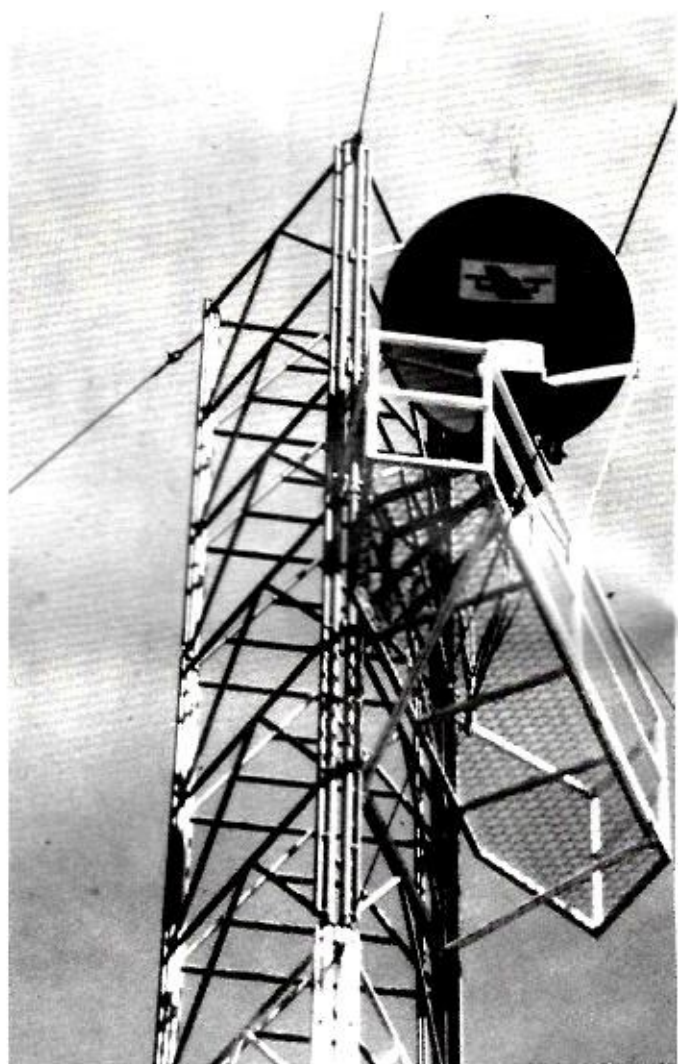
Pylône et parabole téléphonique "Philips" 2 et 15 GHz assurant le faisceau de doublage et montés près du Centre d'Exploitation Télécom.
