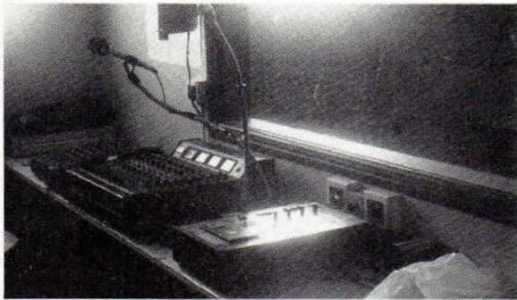
Photo n° 2 — Vue partielle de la cabine. Sur la table on aperçoit de gauche à droite : le pupitre des correcteurs paramétriques, le pupitre de prémélange des micros, le pupitre de diffusion, un magnétophone à cassettes. En haut,
