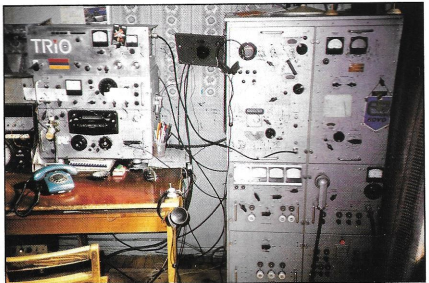
La station du Radio Club d'EREVAN, UG7GNO.
