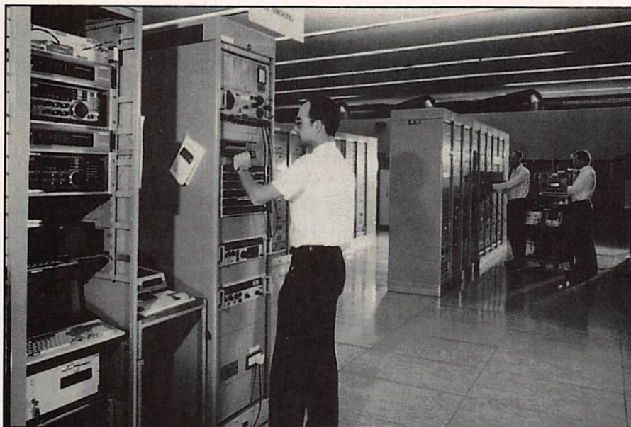
Des baies radio comme celles-ci font partie des moyens techniques mis en œuvre.
