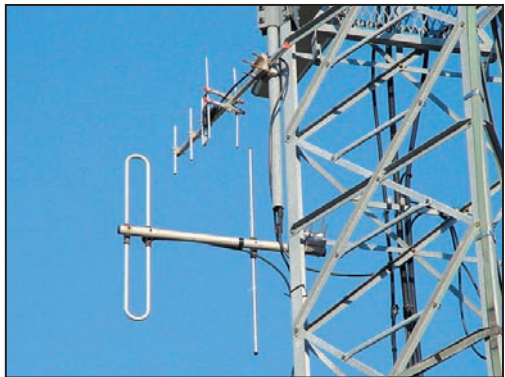
Détail des antennes à Battaglia.
