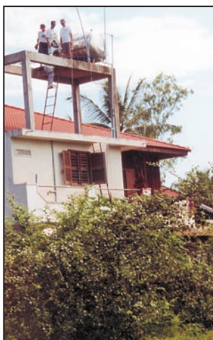
Installation des dipôles sur le toit de la Guest House à Siem Reap.
