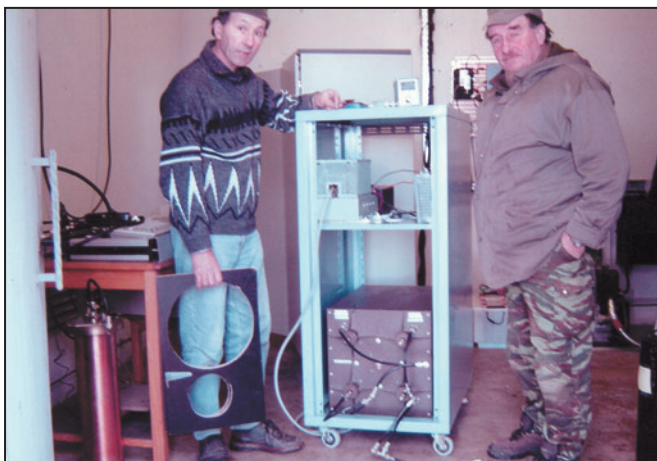
2 - Maintenance sur le Relais de Vazeilles (43) R2X (F5GTL, FIHCE, F-12336).
