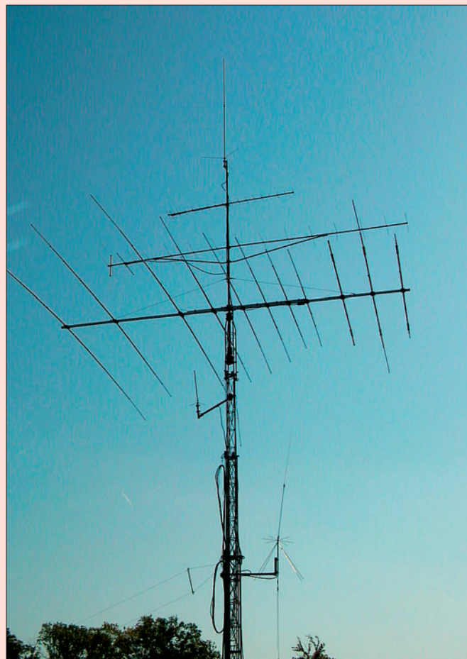
1 - Le pylône est un investissement important dont le choix doit être soigneusement mûri.
