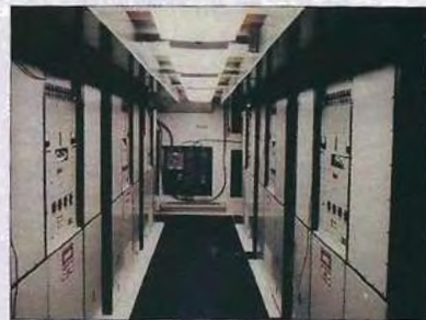
4 - Une vue de l'intérieur des installations.
