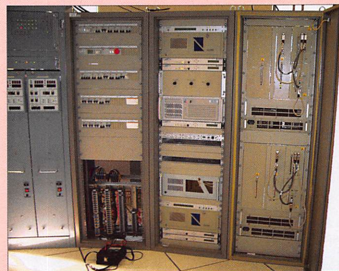
5 - À g. les deux baies de l'ancien radar secondaire mono-impulsion de Montpellier, et à d. le nouveau, Mode S, "CIRIUS" fabriqué par Thalès.
